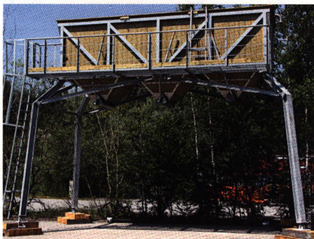
Photo 1 Silo bas à 3 trémies
