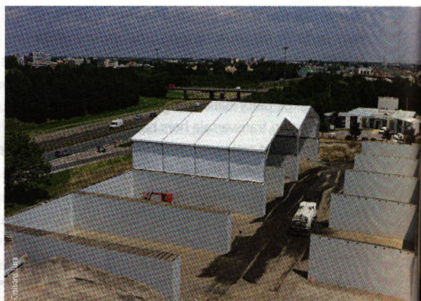
Cloisons en acier chez Eurovia La Verrière-en-Yvelines (78) : 2 hangars à sable et 6 boxes de stockage non couverts
